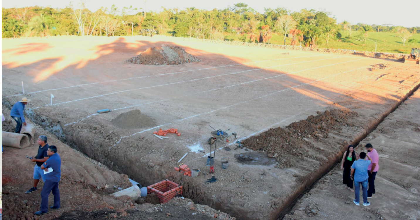
Operários estão trabalhando na drenagem e instalações das tubulações para a irrigação de um dos campos
